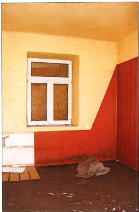
Pomieszczenie we wschodnim narożu budynku z widocznym wtórnie wstawionym oknem pcw. (fot. Jakub Andrzejewski, 2020 r. )
