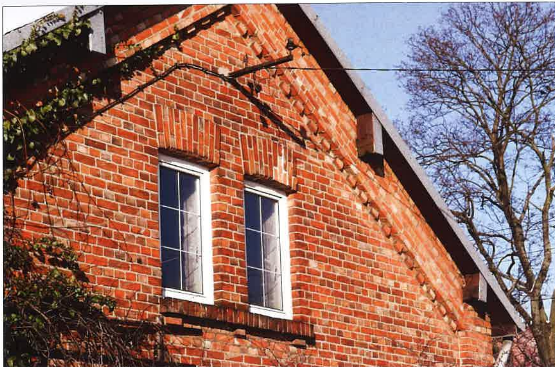
Szczyt elewacji południowo-zachodniej, widoczny prosty fryz kostkowy i poniżej dwa oryginalne otwory okienne z wtórną stolarką pcw. (fot. Jakub Andrzejewski, 2020 r.)
