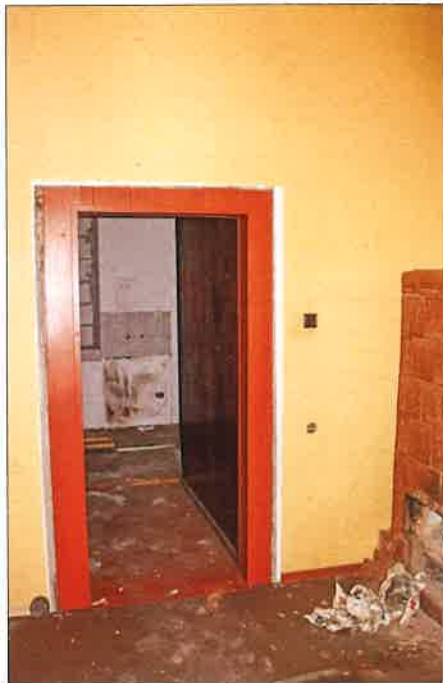
Pomieszczenie we wschodnim narożu budynku, widok w kierunku południowo-zachodnim. (fot. Jakub Andrzejewski, 2020 r. )
