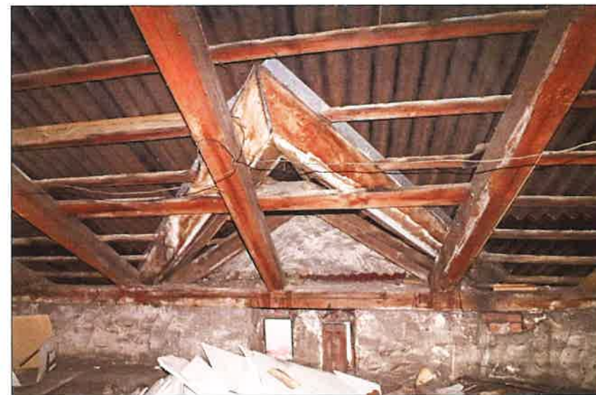
Drewniana konstrukcja wsporcza dachu nad ryzalitem wejściowym w ścianie elewacji południowo-zachodniej. (fot. Jakub Andrzejewski, 2020 r. )
