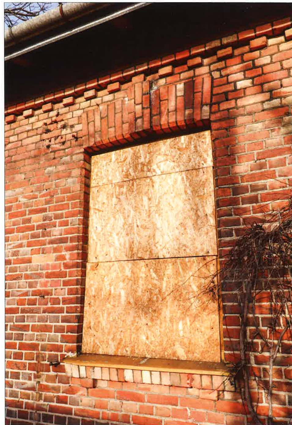
Okno w elewacji południowo-zachodniej wtórnje zaślepienie płytą OSB. (fot. Jakub Andrzejewski, 2020 r.)
